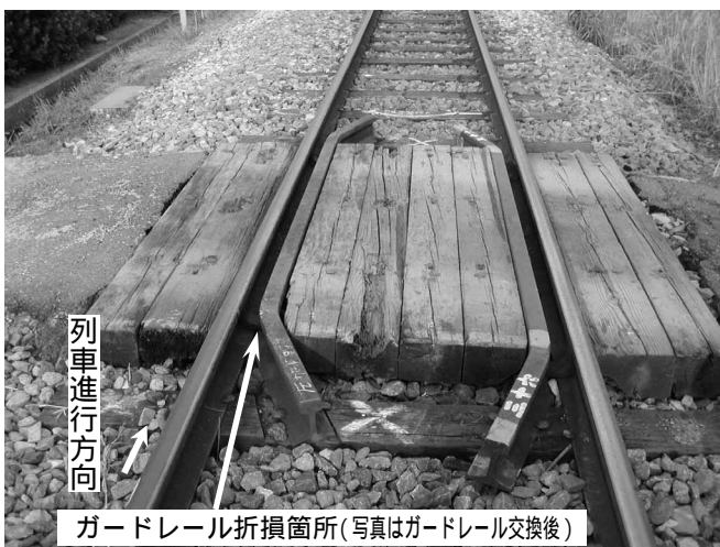
写真3 三十六踏切道の状況
