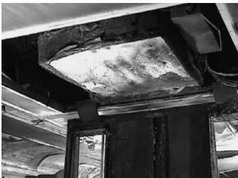
図 24 冷風ダクト(クーラーとの接合部)
