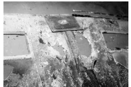
(c) 裏側損傷部(拡大)
