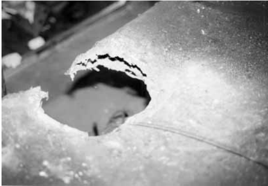
図 21 冷風ダクトの穴状溶損
