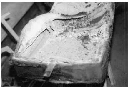
(a) クーラーとの接続開口部の焼損
