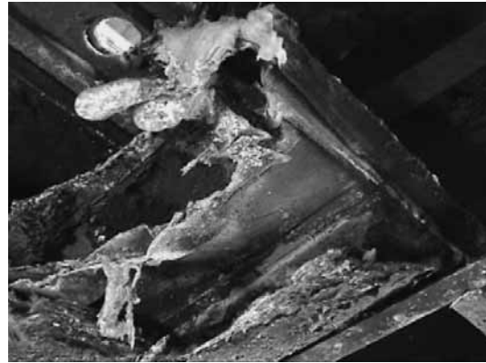
図 22 冷風ダクトの溶損部の断面
