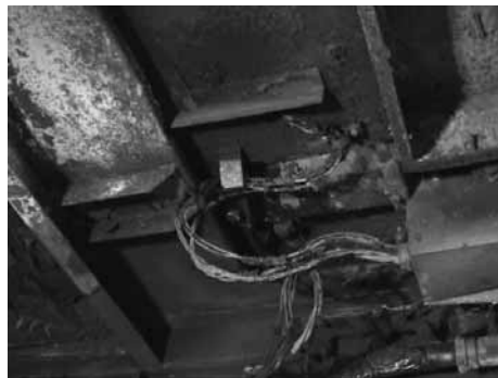
図 27 分電箱の配線の焼損部
