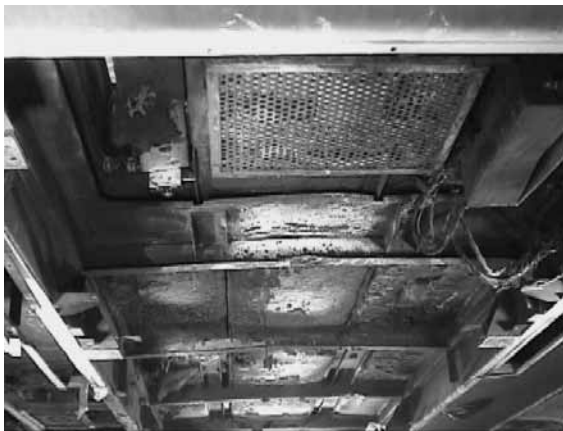
図 26 屋根垂木の熱変形部
