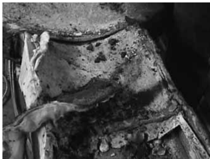
(b) 冷風ダクト上部の焼損、変形
