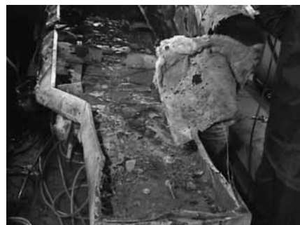
(e) 冷風ダクト内の断熱材の焼損
