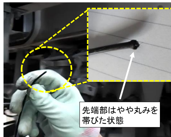
断線状況(先頭側電線)
