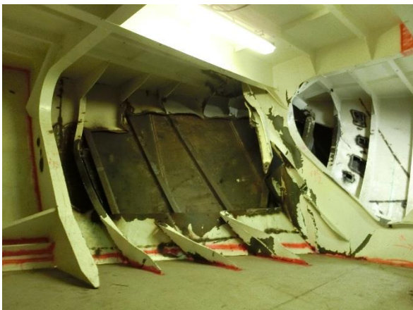
仮修理後の破口箇所の内観
