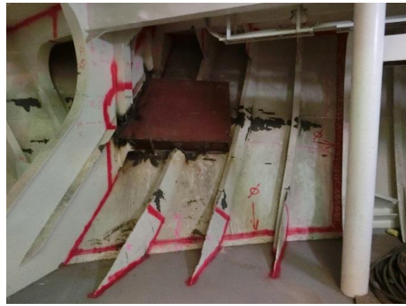
仮修理後の破口箇所の内観
