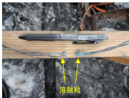
電気配線の断線、溶着等の跡
