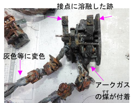
ブレーカーの状態
