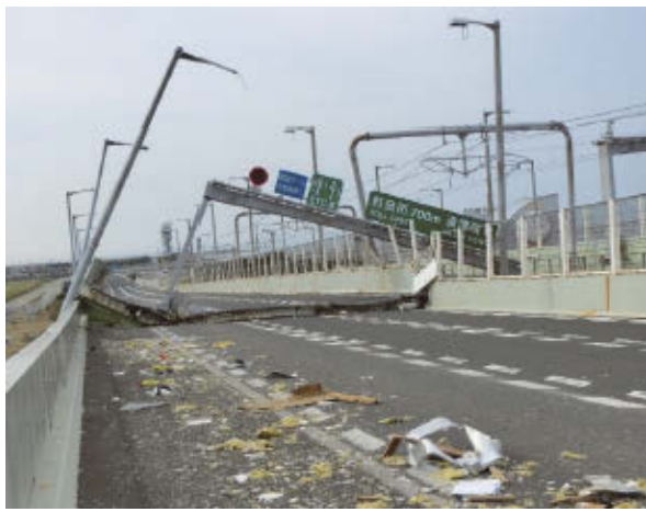
関西国際空港連絡橋の損傷状況
