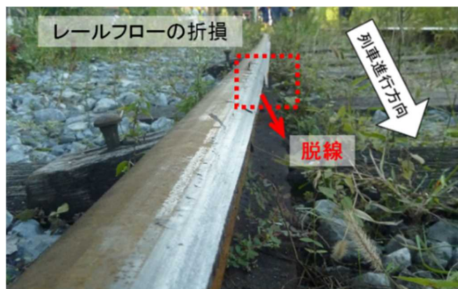
図4 レールフローが折損し軌間内脱線した例
