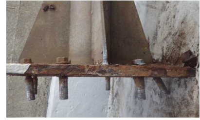
信号機倒壊（新札幌駅構内）
