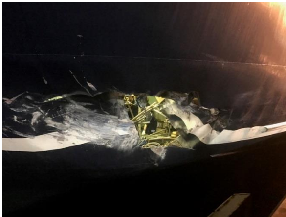
仮修理前の破口箇所の外観
