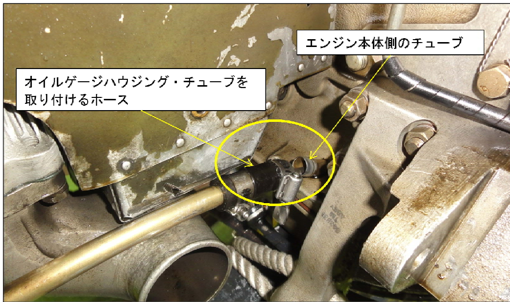
ホースがエンジン本体側のチューブから外れた部分の再現
