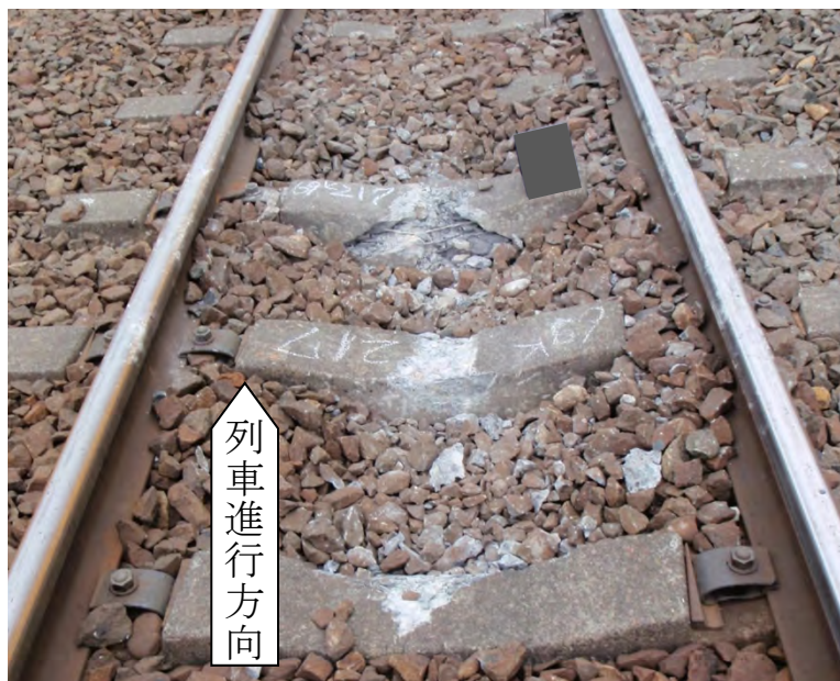
損傷したまくらぎ (列車停止位置から2.39km手前付近)
