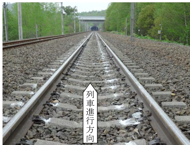
清風山信号場構内の脱線痕
