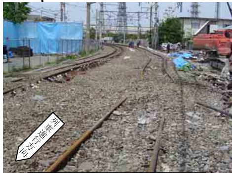
車両の撤去後、マンション付近から福知山駅方を撮影
