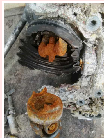
腐食・破断した ユニバーサルジョイント
