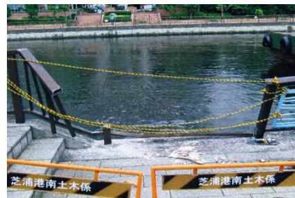
転落防止柵の損傷状況
