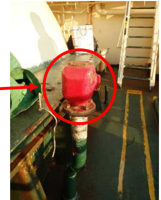
左舷 3 番 A 重油タンクの空気抜き管
