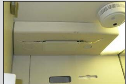
化粧室天井部の亀裂破損
