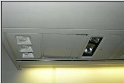
客室天井部のパネルの損傷
