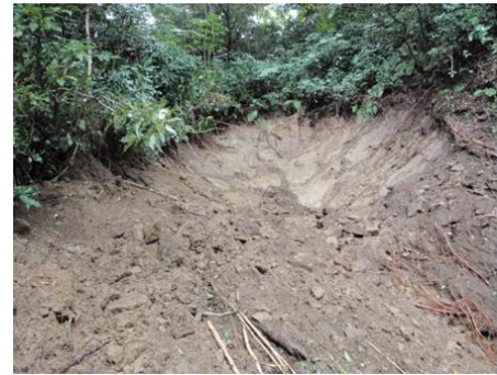
崩壊発生箇所
