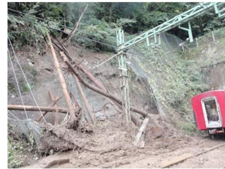
崩壊したのり面
