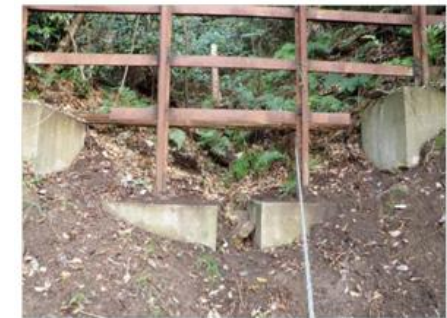
露出したコンクリート基礎の一部
