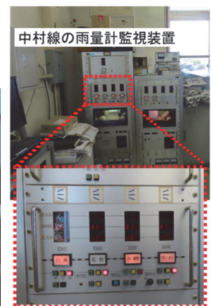
図3 雨量計監視装置
