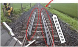
図 脱線防止ガード及び監視カメラの設置状況
