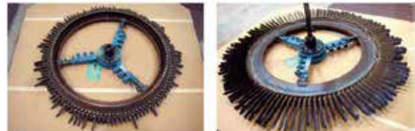
LPT第5段（左側）及び第6段（右側）動翼の損傷状況
