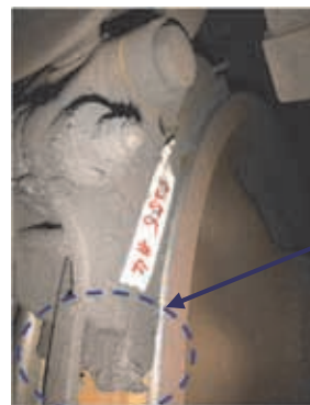
堆積した制輪子付着物の例 7両目 #4車輪の制輪子 制輪子交換日 H25.4.10
