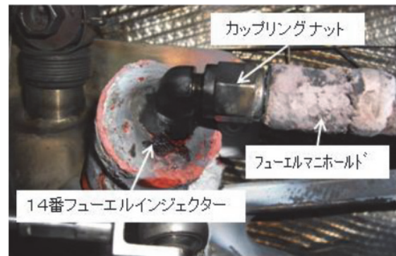
漏洩が確認されたナット周囲
