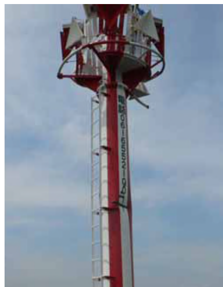
損傷した大阪灯標 (凹損及び亀裂)
