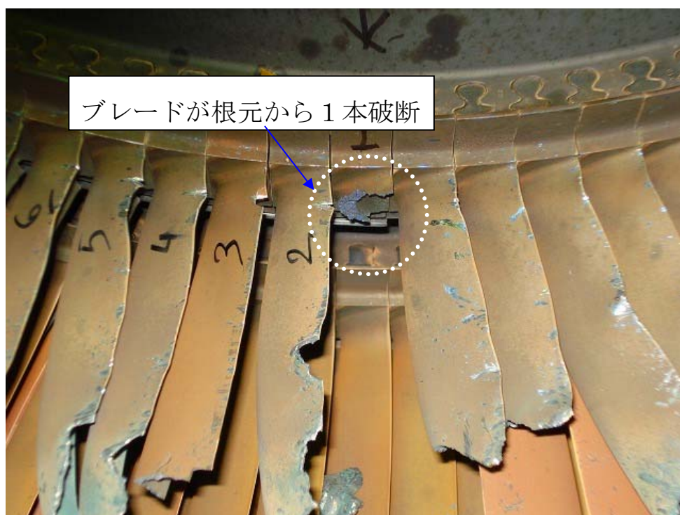
写真4 L P T STG-2 タービン・ブレードの破断状況
