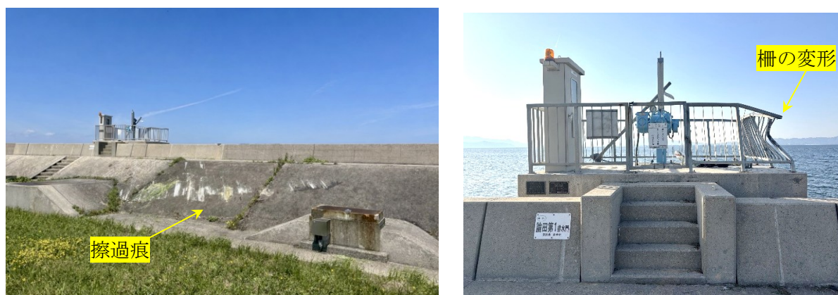
図2 同機が衝突した防潮堤及び河川施設
