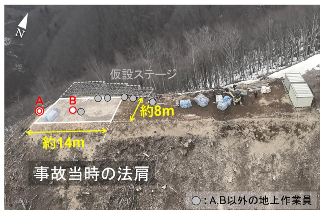
図2 上空から見た事故現場及び法肩
