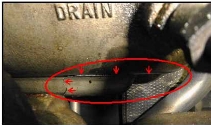
写真# 13-2 燃料滑油熱交換器の外側ケースの亀裂
