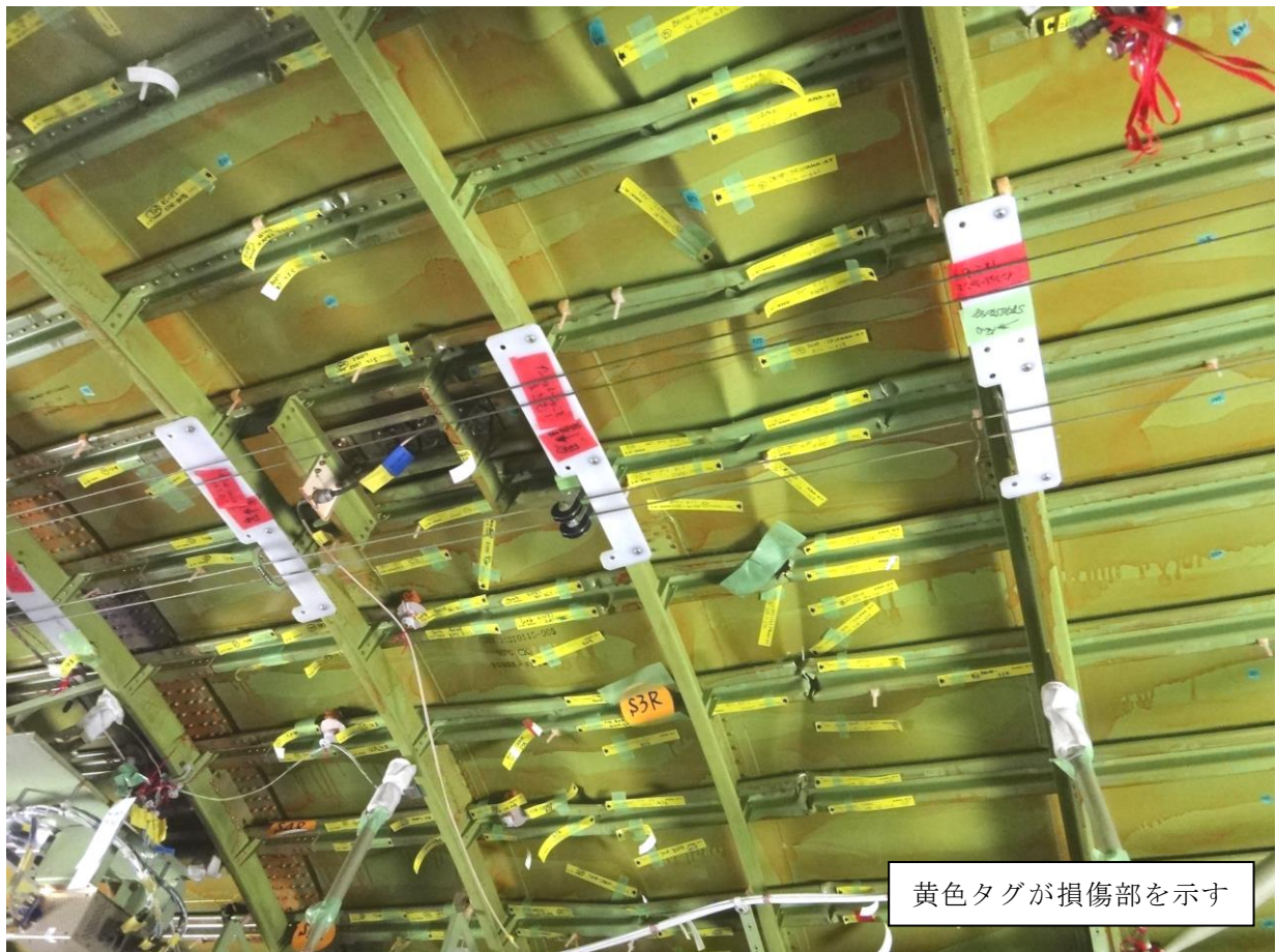
写真2 外板及び構造部材の破断及び変形
