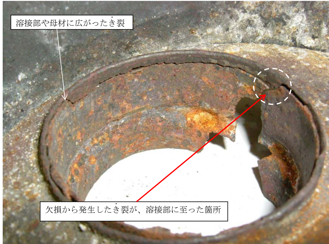
外れた左前方接続パイプの溶接面
