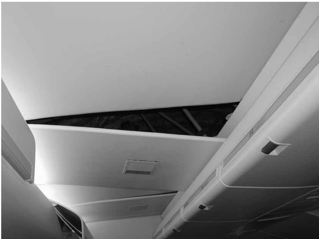
写真2 外れた天井パネル
