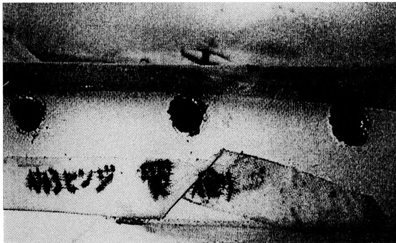
主翼側No. 3 ヒンジのリベットの抜けた穴
