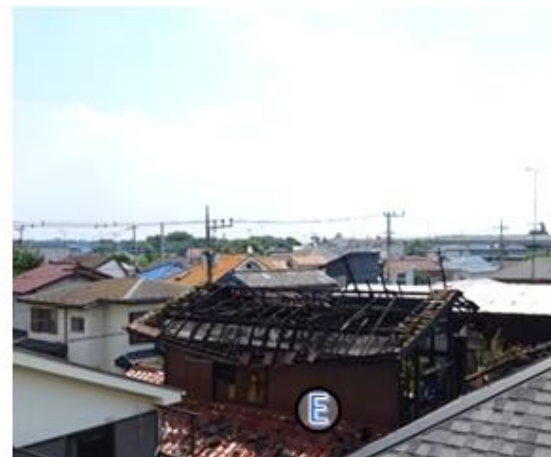
写真2.4.2-6 住宅Eの焼損状況
