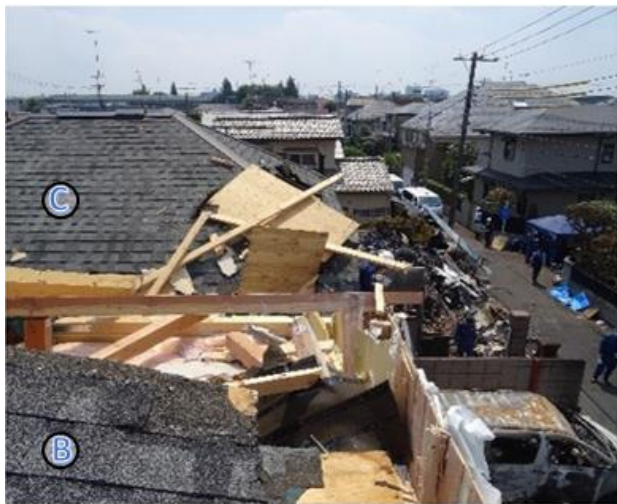
写真2.4.2-3 住宅Bの破損した屋根及びその屋根材が散乱した住宅C
